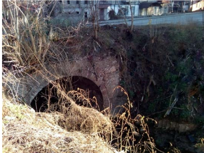
48. Вхід до міського колектору, що розташований на розі вулиць Паторжинського та Південної
